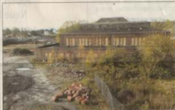
Für die rund 50 000 Quadratmeter große Caroline-Fläche meldet ein Rünther Bauträger Kaufinteresse an. Die alte Bausubstanz auf dem Gelände soll derweil noch in dieser Woche fallen. • Archibild
