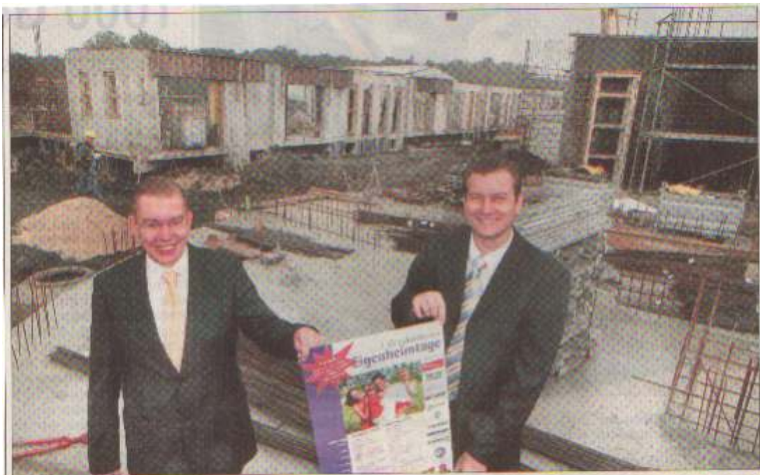
Beta-Geschäftsführer Dirk Salewski und Marc Römant stehen auf der Baustelle. kommenden Samstag wird im Turmbau der Grundstein gelegt. Die Bürgerinnen und Bürger sind Samstag und Sonntag zu den ersten Bergkamener Eigenheimtagen eingeladen. • Foto: Stefan Milk
