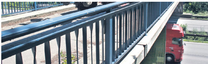
Der Wirtschaftsweg über die Autobahn ist eine wichtige Verbindung für Radfahrer und Spaziergänger und knüpft an das Radwegenetz des Kreises Unna an. Sie soll für die Verbreiterung der Autobahn abgerissen werden. Politik und Verwaltung fordern einen Ersatz für Fußgänger und Radfahrer. Der landwirtschaftliche Verkehr wird dann über die Vincenz-Wiederholt-Straße geschickt. Foto: Hennes
