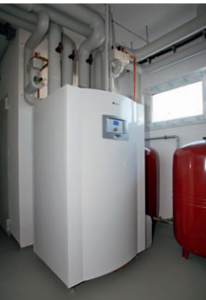
Die Wärmepumpe T 600-1 mit einer Heizleistung von 61,5 kW.
