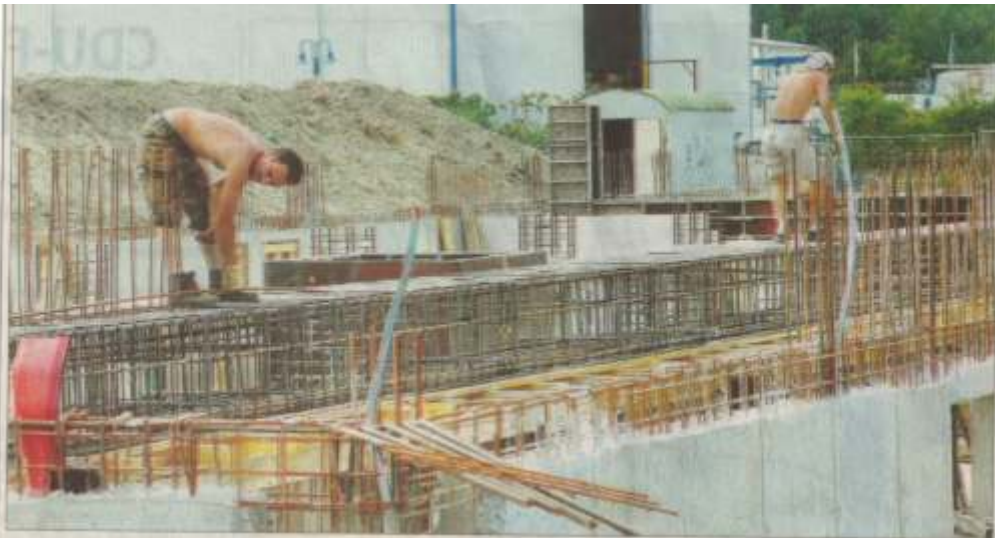
Zwei der vielen Arbeiter treiben den Bau des Beta-Gebäudes am Hafen in Rünthe voran. Die Kellerwände haben sie bereits hochgezogen, noch in diesem Monat wird die Decke gegossen.
