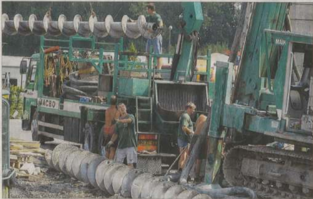
Unter Hochdruck wird auf der beta-Baustelle am Hafenweg gearbeitet. Und das hat Gründe: Noch im August soll Grundsteinlegung, im September bereits Richtfest gefeiert werden. „Zum Hafenfest im nächsten Jahres ist dann alles fertig“, zeigt sich beta-Chef Dirk Salewski überzeugt.
